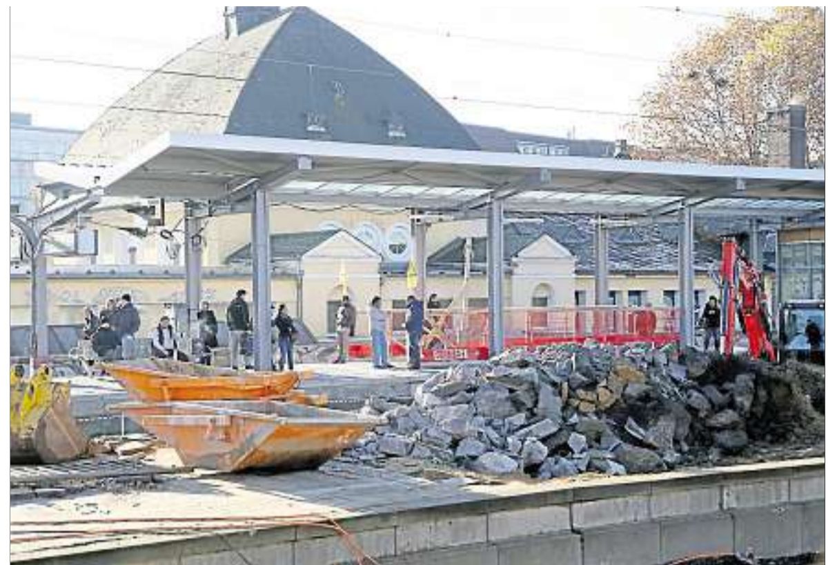
Gerade wird der zweite Bahnsteig umgebaut; der erste scheint schon fertig. Aber soll das Bahnsteigdach wirklich so kurz bleiben? Foto: Maik Reuß
